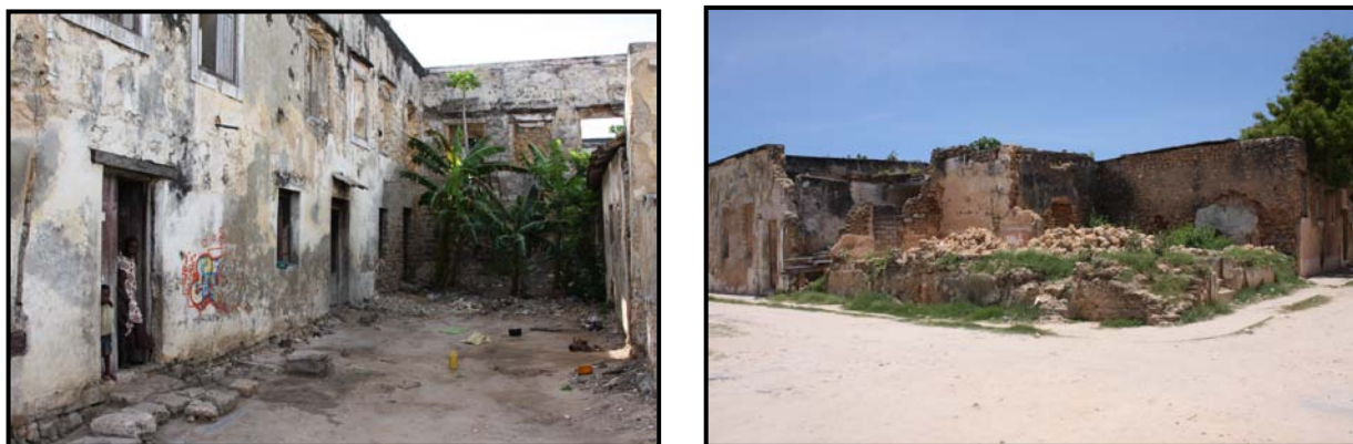
Fig. 12. Exemplos do avançado estado de degradação de alguns imóveis (Foto de Filipe Branquinho 2010).
